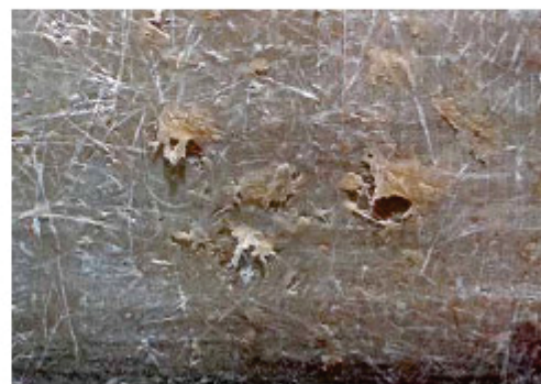
O problema estético pode se tornar estrutural
